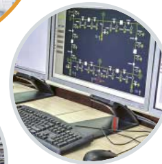
Steuerung und Regelung
